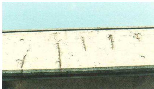
コンクリートのかぶり厚さ不足
