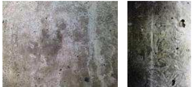
初期凍害を受けたコンクリート (右の写真では氷の結晶の跡が残っているのが分かる)
