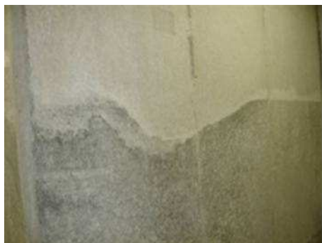
コンクリートの色むら
