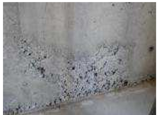
壁の下部に生じた豆板
