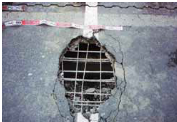
劣化期の床版コンクリートの抜落ち
