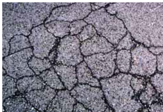
加速期のひび割れの網細化と角落ち
