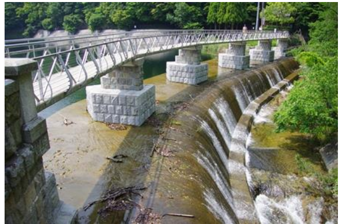
非常用洪水吐
