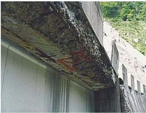
凍結膨張による剥離、鉄筋露出
