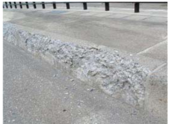
スケーリングが進行している縁石
