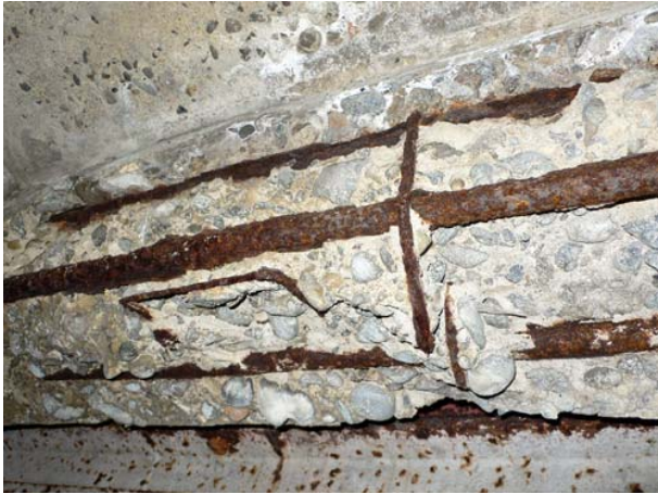
劣化期の激しい劣化
