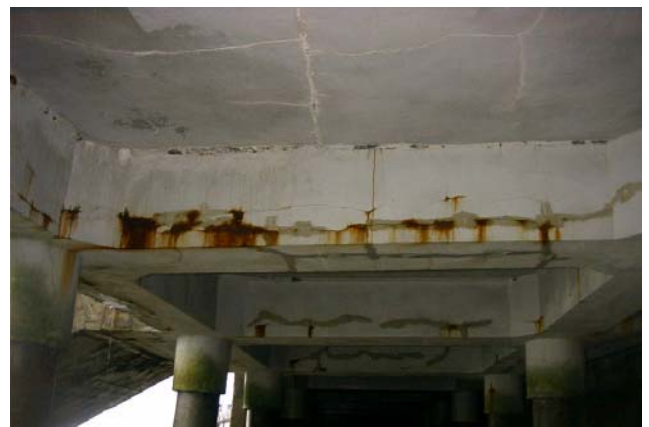
加速期の塩害劣化
