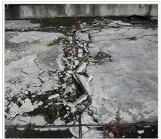
コンクリートの凍結融解による損傷
