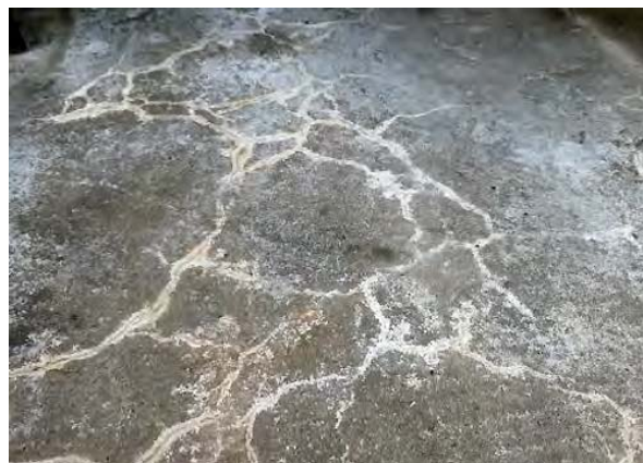
亀甲状のひび割れ
