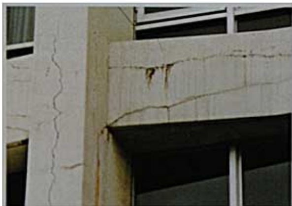
柱、梁に発生した軸方向のひび割れ
